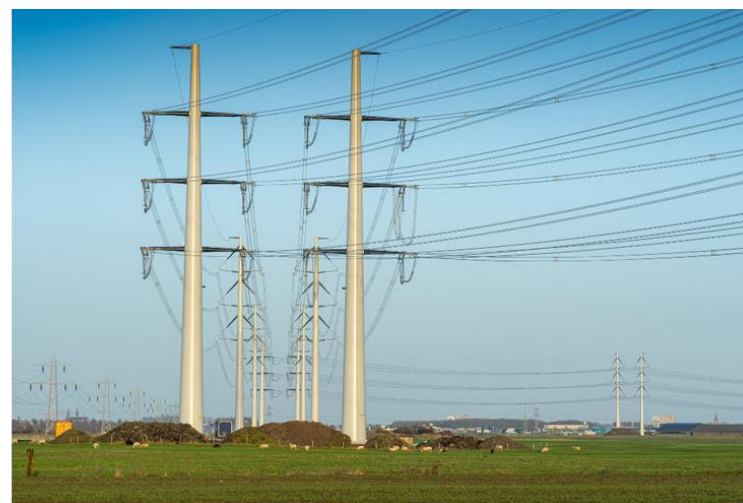
2 wintrackpylonen met 4 stroomcircuits
