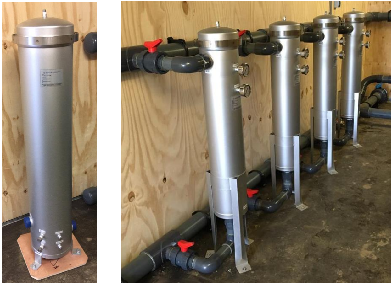
Figuur 2-15: De voorzuivering met het kaarsenfilter (links) en de vier voorgeschakelde zakenfilters (rechts).
