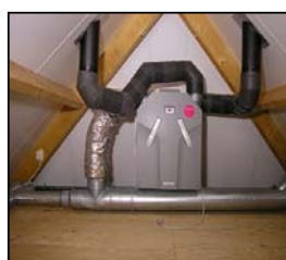
Ventilatie WTW www.hetbinnenklimaat.nl
