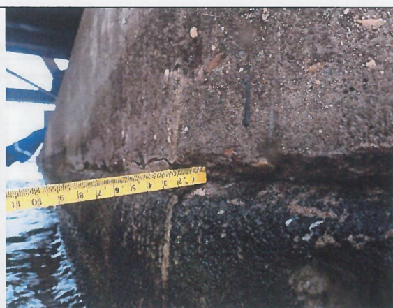
Figuur 0.4: Voegvulling verdwenen.
