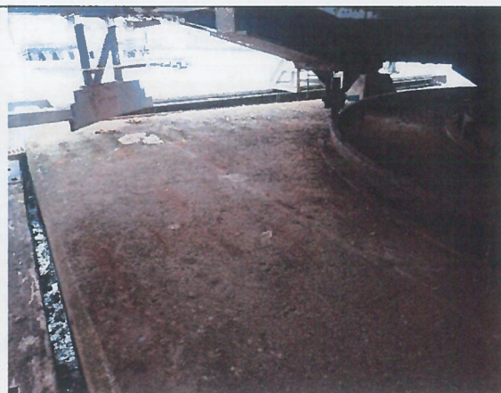
Figuur 0.6: Oppervlak met corrosie sporen.
