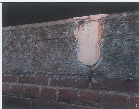
Figuur 0.2: Reparatieplekken met corrosiesporen.
