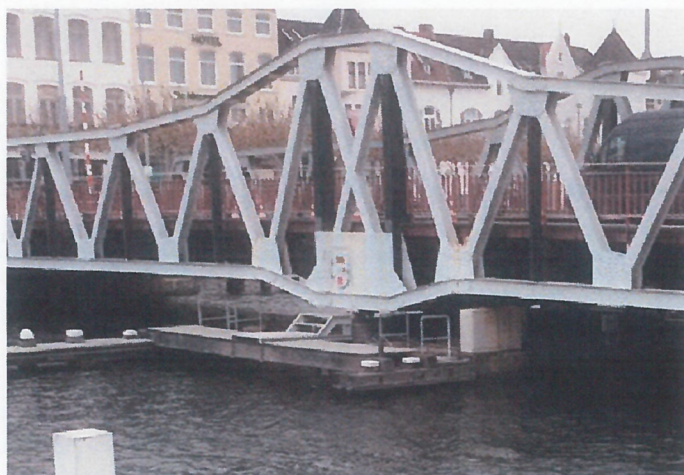
Figuur 5: hulpconstructie aan middenpijler (aanwezig aan beide zijden brug)
