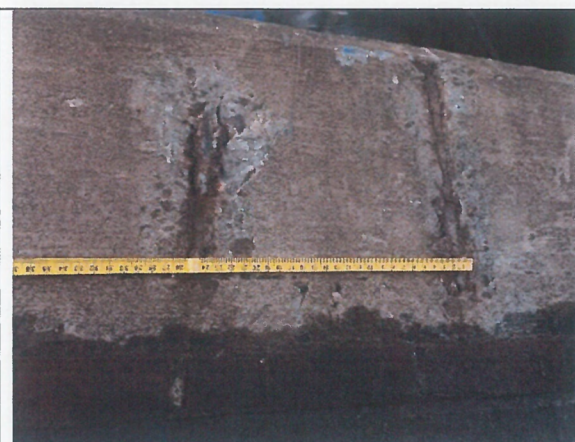
Figuur 0.1: Betonschade met zichtbare wapeningscorrosie.
