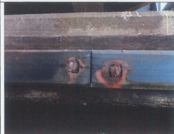
Figuur 0.5: Bevestiging wrijfgording gecorrodeerd.
