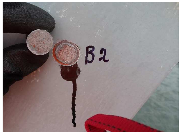
Foto 6, meetresultaat pull off op hoofddragconstructie boven rijbaan. 100% cohesief in 2 e laag (C)
