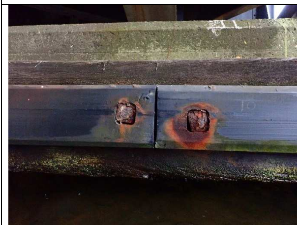
Figuur 0.5: Bevestiging wrijfgording gecorrodeerd.
