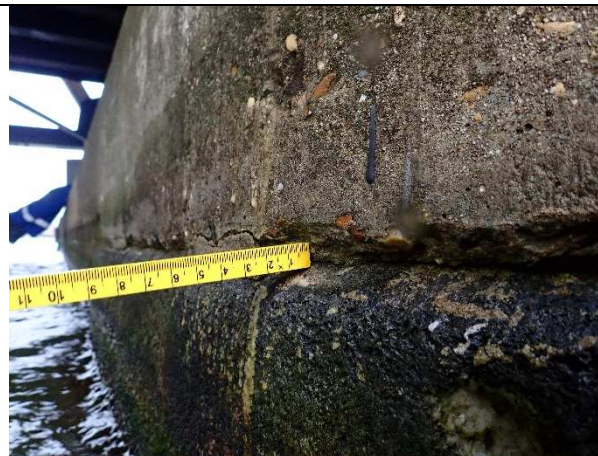
Figuur 0.4: Voegvulling verdwenen.
