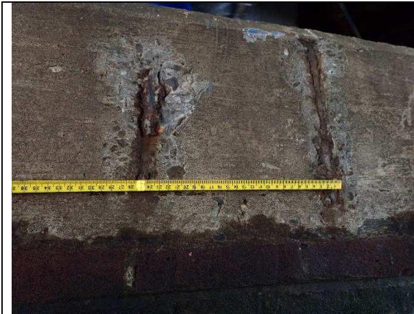
Figuur 0.1: Betonschade met zichtbare wapeningscorrosie.
