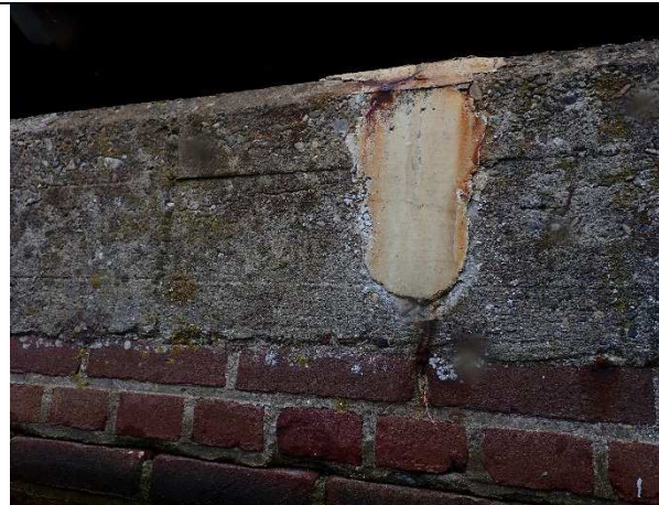
Figuur 0.2: Reparatieplekken met corrosiesporen.
