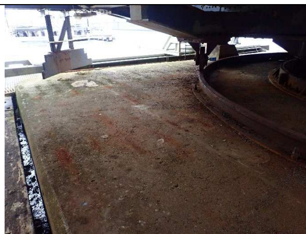
Figuur 0.6: Oppervlak met corrosie sporen.
