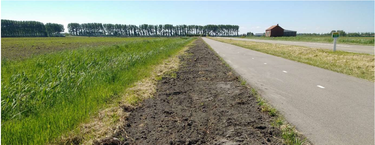
Graafwerk in de berm van de Stadseweg was één van de verstoringen. Foto 16 mei 2019
