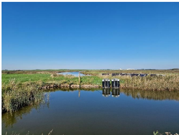
Stuw Everseweg, de verbinding tussen YM noord en YM zuid. Op de foto zijn de pompen op zonne-energie zichtbaar. Twee zijn in beheer van het Zeeuws Landschap en 2 zijn van het Waterschap Scheldestromen.
