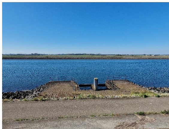
Benedenstrooms gemaal De Moer met uitlaatconstructie in het Kanaal door Zuid-Beveland.
